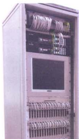
Рисунок 1 Общий вид оборудования с открытой дверью
